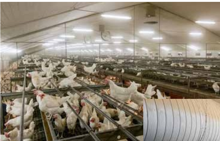
Luften fra varmeveksleren blåses inn midt i hønsehuset og fordeles med en serie av ventilatorer
